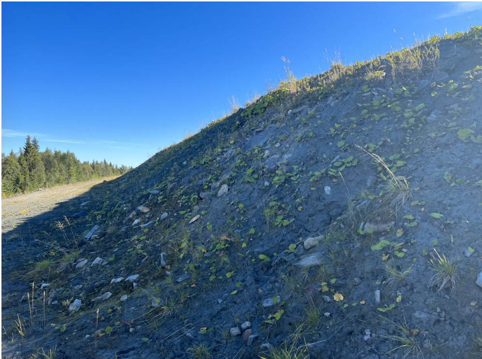
Kuva 17. Pato 1, lounauskulman ulkoluiska, josta aiemmin korjattu sadevesieroosiota
