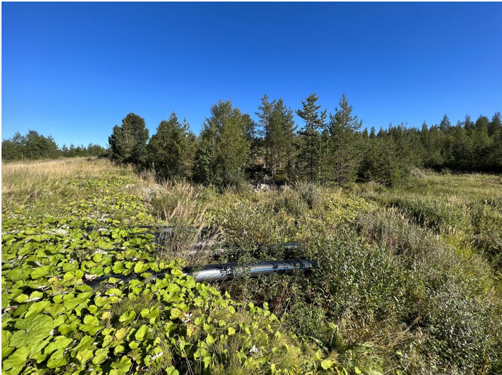
Kuva 14. Pato 2 ylivuotoputket selkeytysaltaan puolella
